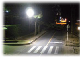
設置されたLED照明
