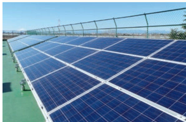
自然環境を生かした再生可能エネルギーは持続可能な社会のために重要な電源となる
