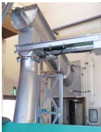
汚泥搬送コンベヤ(搬出口) Sludge Removal Conveyor (Exit Ramp) ホッパーに貯められたし渣や汚泥を搬出用のコンテナに搬送します。
