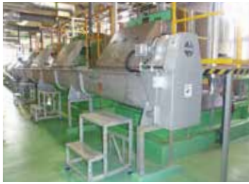
分離機 (多重円盤) Dewatering Machine (Multi-Disc)
