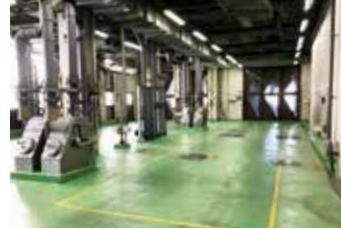
受入室 Vacuum Truck Unloading Area 出入りに自動ドアを設置し、前室、後室を設け、臭気が外部に漏れるのを防いでいます。
