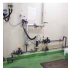
接触槽・放流槽 Chlorine Contact and Treated Water Tank 大腸菌を殺菌し、衛生的で安全な水にして放流します。
