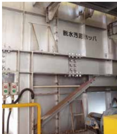
脱水汚泥ホッパー Sludge Dewatering Hopper 処理工程で出てきた汚泥を一時的に貯留します。
