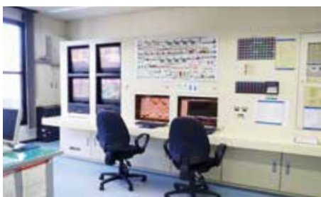
中央監視室 Central Control Room
