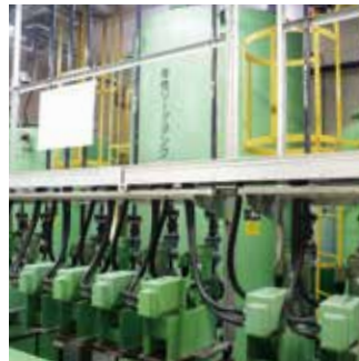
薬品タンクヤード Chemical Tank Yard
