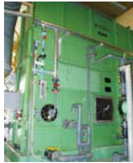
水・アルカリ次亜洗浄脱臭塔 Water, Alkali and Sodium Hypochlorite Scrubbing Odor Control Tower
