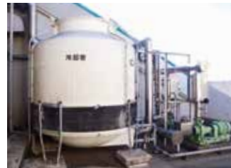
クーリングタワー Cooling Tower 硝化脱窒素槽内の冷却をします。微生物の活動による液温の上昇を抑えます。
