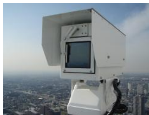
(通信用鉄塔に設置された高所カメラ)
