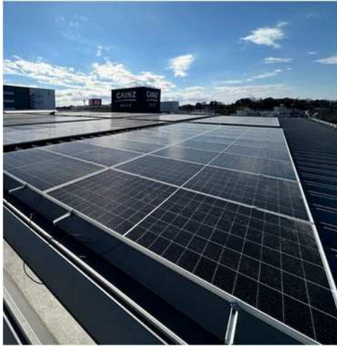
太陽光発電設備:142kw (既存設備と合計で約550kW)
