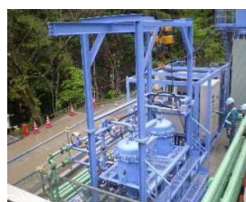
トンネル工事濁水
