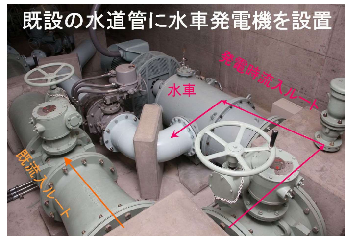
写真 5 小水力発電設備の設置状況
