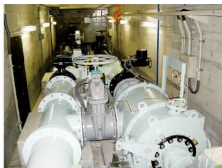
写真 5-5-2 小水力発電設備(大宮配水場)
