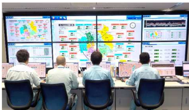
写真 3-3-1 中央管理室(全 20 か所の浄・配水場の運転管理を実施)
