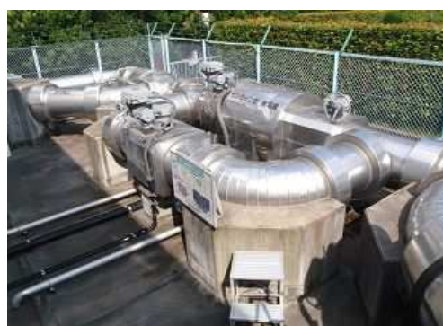
写真 3-6-4 小水力発電設備(白幡配水場)
