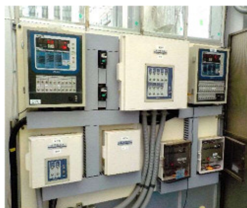
機器類の制御盤
