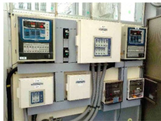
機器類の制御盤
