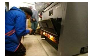
▲町内民間事業者が薪ボイラーを導入
