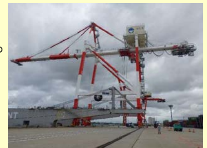
<ガントリークレーン6号機を岸壁上のレールにセットしている様子>
