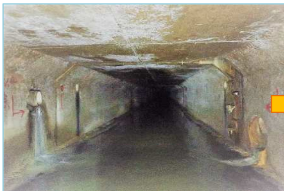
老朽化した下水道管
