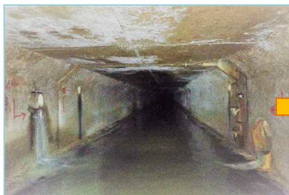
老朽化した下水道管
