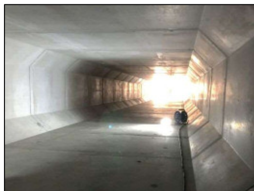
浸水対策 雨水幹線[油面第1号幹線]
