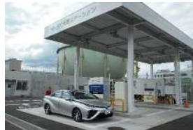
浦和水素ステーション （都市ガスによる水素製造・天然ガススタンド併設）
