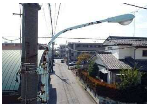
修繕を要する公衆街路灯
