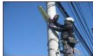
道路照明灯のLED化
