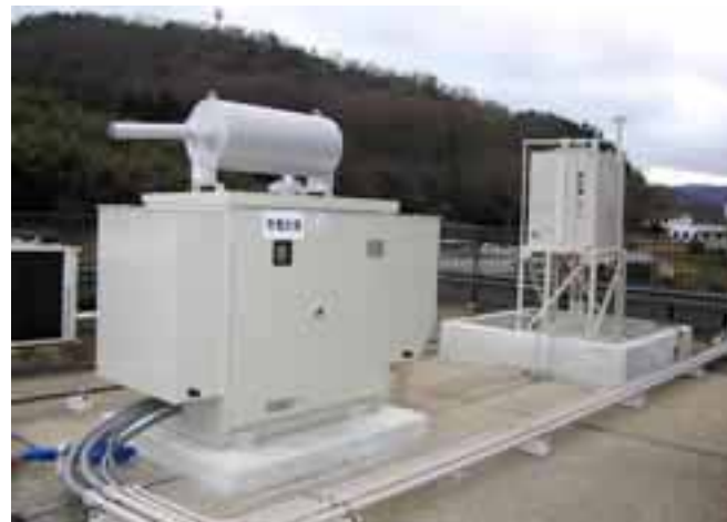
非常用自家発電設備イメージ
