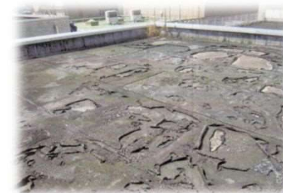
▲屋上防水の劣化状況
