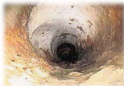
▲配管の劣化状況
