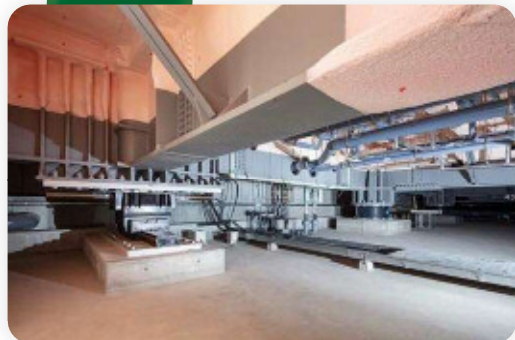
▲地下免震装置
