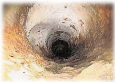
▲配管の劣化状況
