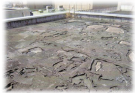
▲屋上防水の劣化状況
