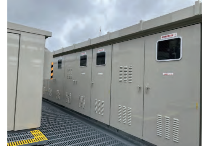
屋外キュービクル (屋上)
