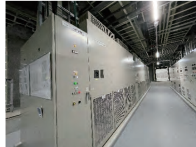
屋内キュービクル
