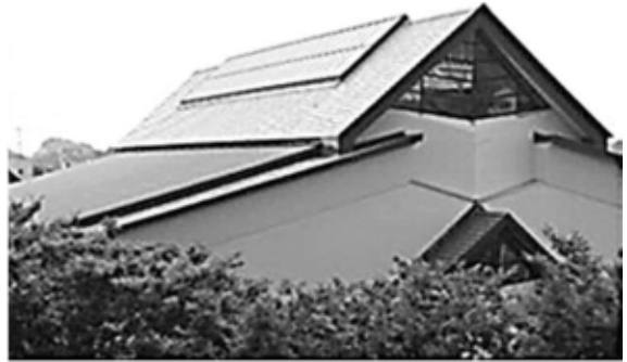
【大宮武道館の太陽光発電設備(32.3kW)】
