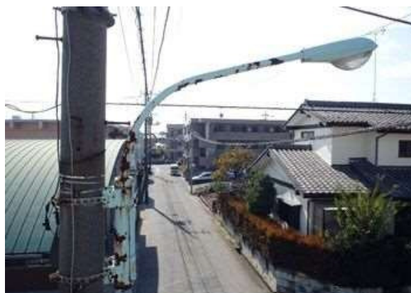
修繕を要する公衆街路灯
