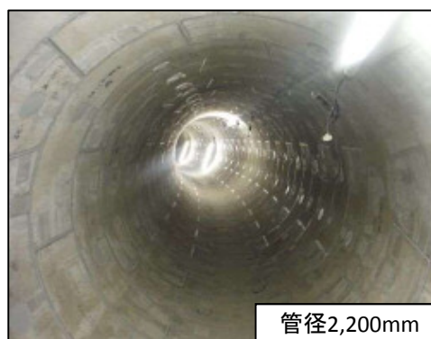
浸水対策 雨水貯留施設[大門浅間8号幹線]
