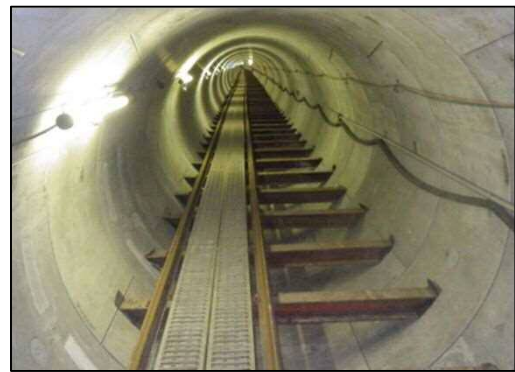
浸水対策 雨水貯留施設 [公園4号幹線]
