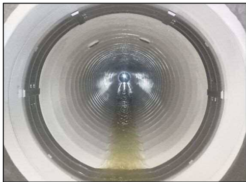
地震対策 管きょ耐震継手 [谷場幹線]
