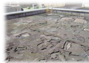
▲屋上防水の劣化状況
