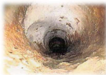
▲配管の劣化状況
