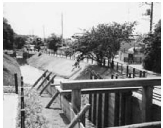
▲②整備後の見沼通船堀(東縁)の様子 復元された閘門(手前が二の関、奥が一の関)や堤塘
