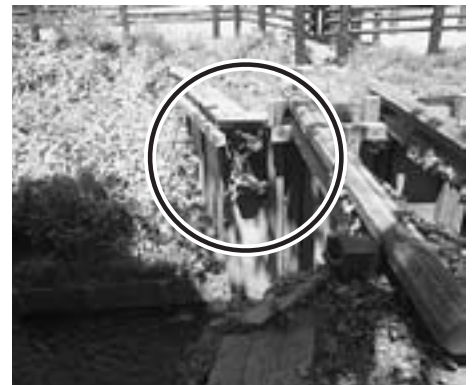
▲⑤関杵側板の欠損(東縁一の関) (丸杵部分)
