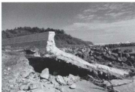
▲津波の引き波で破壊された防潮堤(相馬市)
