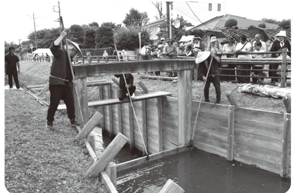
②角落(かくおとし)と呼ばれる板を関枠に取り付け、水をせき止めることで水位を上昇させていきます。
