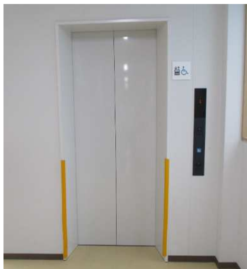
エレベーター
