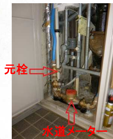
パイプスペース
