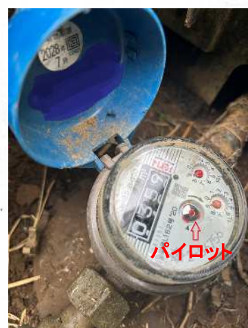
水道メーター
