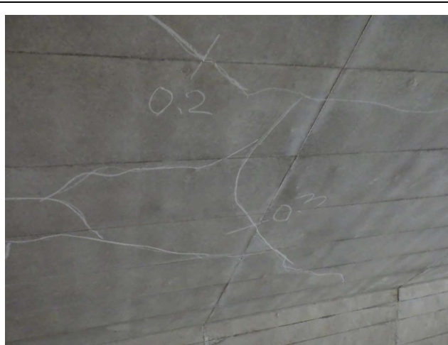
ひび割れ 健全度Ⅱ 対策区分Ⅱa* (中尾トンネル)
