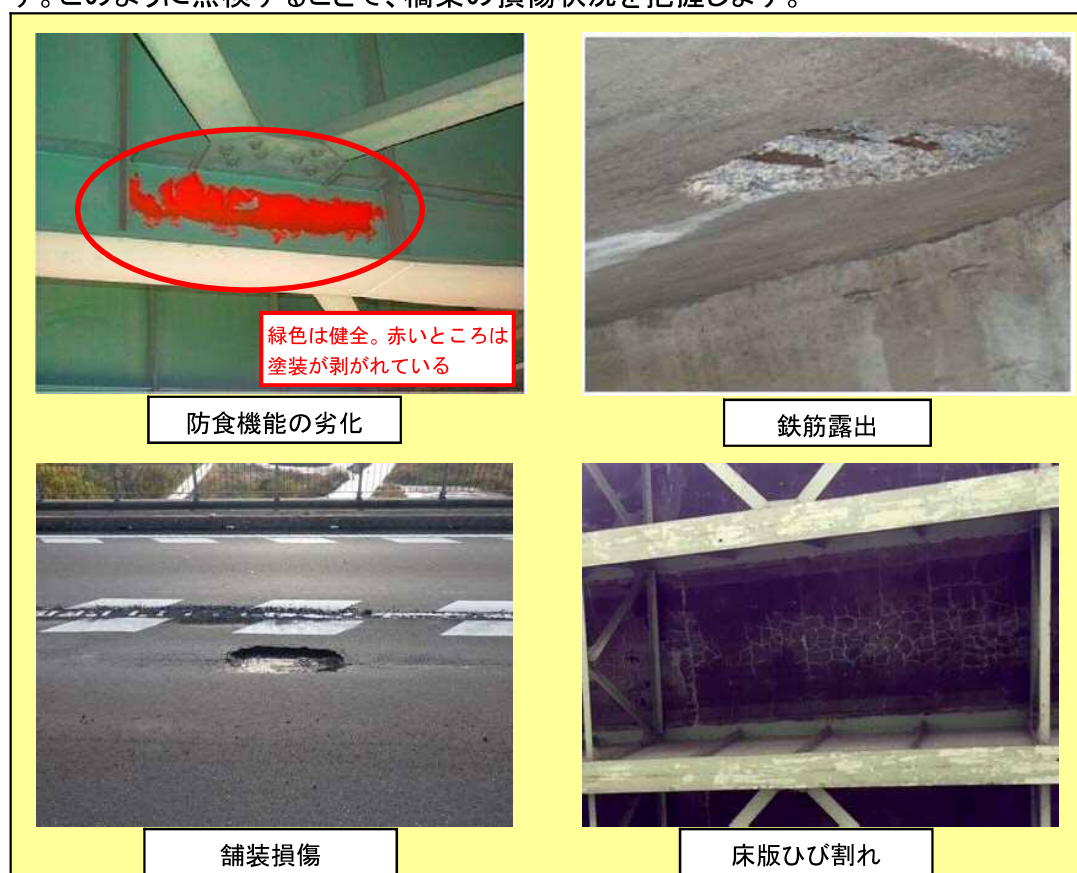
橋梁の損傷例
