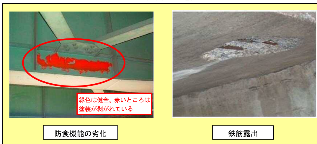
歩道橋の損傷例
