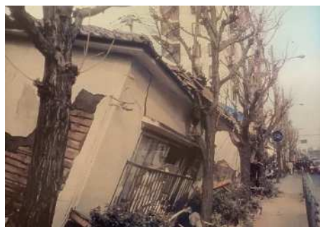
災害発生時に建物倒壊防止に機能した例
