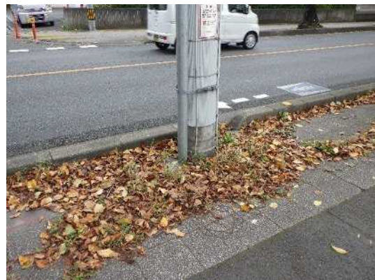
落葉の堆積 (市道 10709 号線外、宮原駅前通り)
