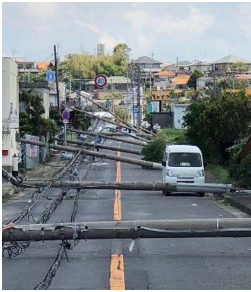
台風により倒壊した電柱
