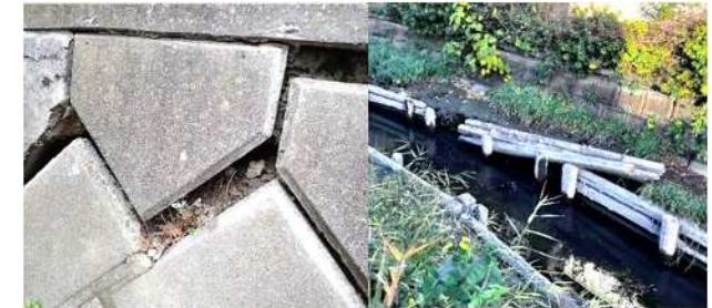
ブロック護岸の崩れ、木柵欠損
