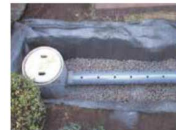
雨水浸透トレンチ
