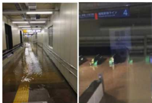
（JR武蔵小杉駅構内内水被害）
