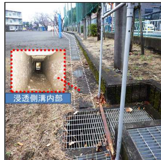
校庭貯留施設
