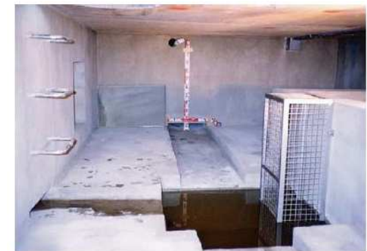
貯留施設 (地下貯留)
