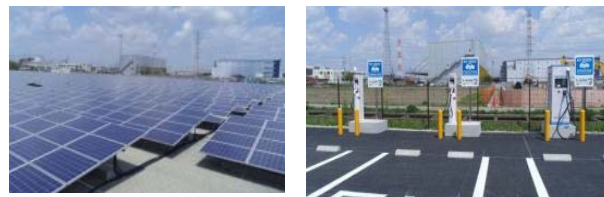
＜やまぶきエネルギーパーク(岩槻区)＞ 太陽光発電による蓄電、急速充電器併設
