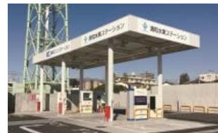
＜浦和水素ステーション(桜区)＞ 都市ガスにより水素製造、天然ガススタンド併設
