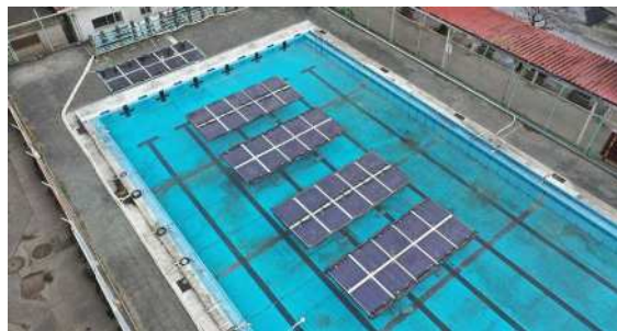
浮体式ペロブスカイト太陽電池
