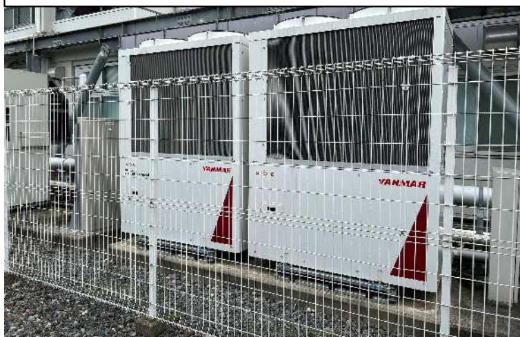
高効率空調（ガスヒートポンプ）へ更新
