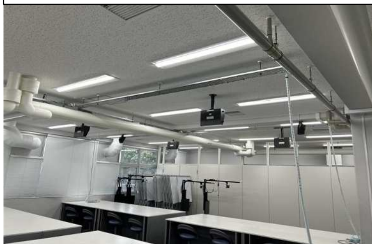
学内全ての照明をLED化
