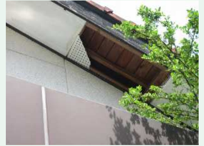
地震で破損した軒天井のけい酸カルシウム板第1種(有孔板)
