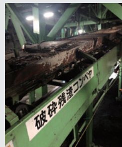
破碎残渣コンベヤ
