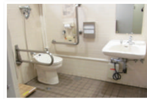
▲多目的トイレ1F-箇所2F二箇所
