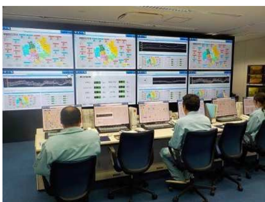
配水管理事務所中央管理室
