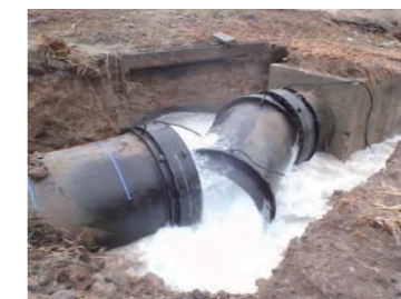
▲非耐震継手管の様子（被害あり） （公益財団法人日本水道協会提供）
