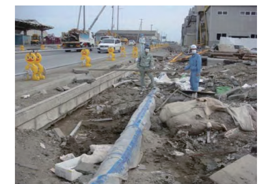
▲耐震継手管の様子（被害なし） （公益財団法人日本水道協会提供）
