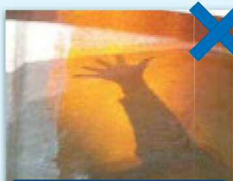
外面劣化による光の透過
