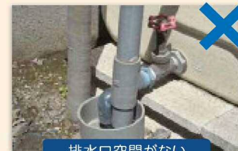
排水口空間がない
