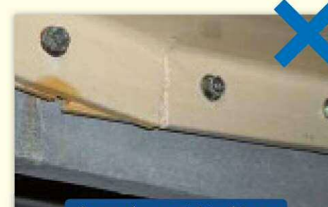
亀裂があり改善が必要
