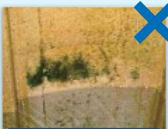
内部壁面に藻が発生
