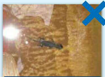
水槽内部に小動物の死骸
