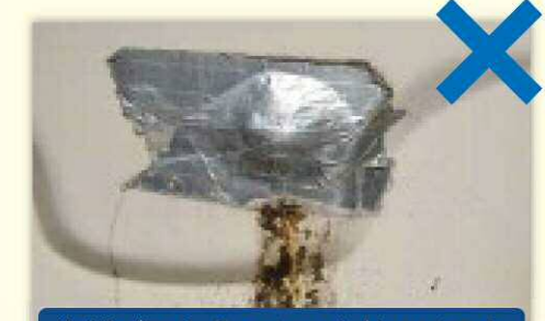
修繕が不十分のため本体より漏水
