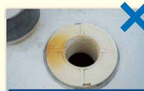
防水密封されていない開口部
