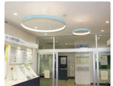
LED化（水道庁舎）
