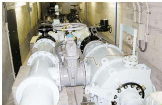
小水力発電（尾間木配水場）
