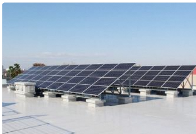
太陽光発電（水道庁舎）
